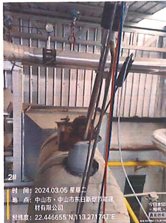
8: 天然气燃烧废气排放口 2#监测点
